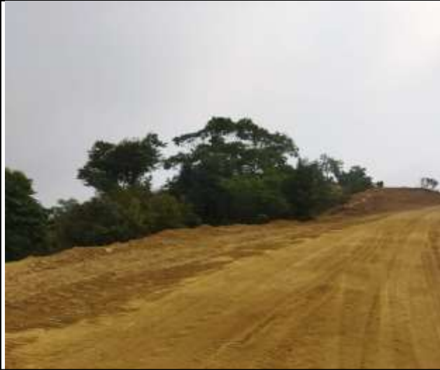
वडा नं ९ मा निर्माण भएको देवीकोटदेखि रुपाकोट जाने बाटोको अवस्था ।
